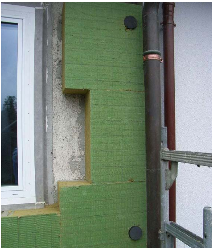
Abbildung 8-7: Befestigungsrondellen, eingelegt für zukünftige Abgasleitung.
