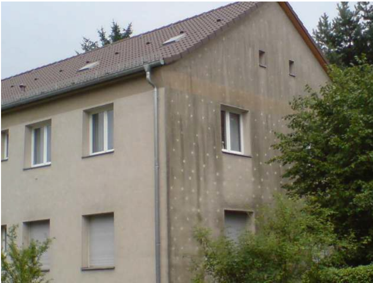
Abbildung 2-4: Algen-/Pilzbewuchs an einer Nordfassade (unbekannt)
