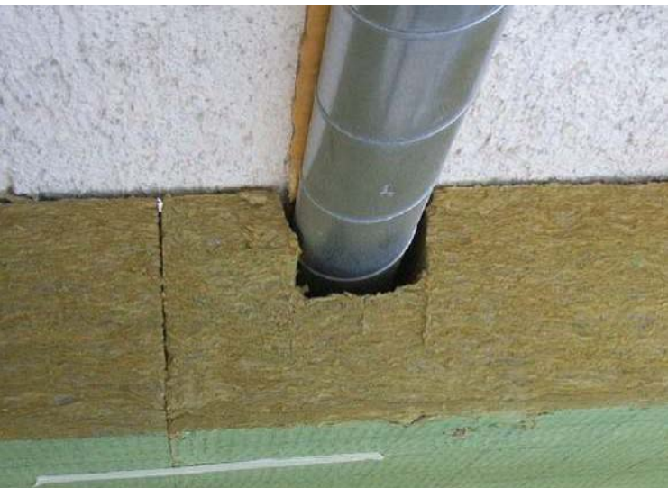
Abbildung 6-4: Dämmung der Lüftungsleitungen (2)
