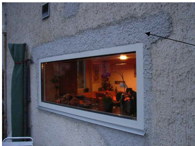
Abbildung 4-12: Beispiel eines "richtigen" Fensterersatzes, damit später problemlos die 2. beste Lösung realisiert werden kann.
