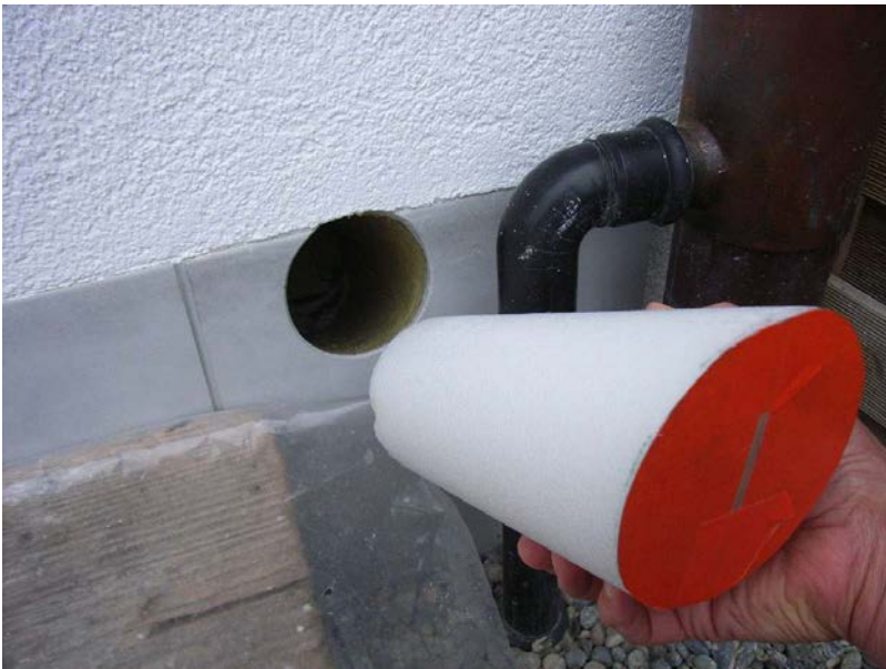
Abbildung 3-13: Runde, 45°steigende Aussparung (siehe Abbildung 3-11) für ein Abgasrohr mit Verschlusskern aus Schaumstoff.
