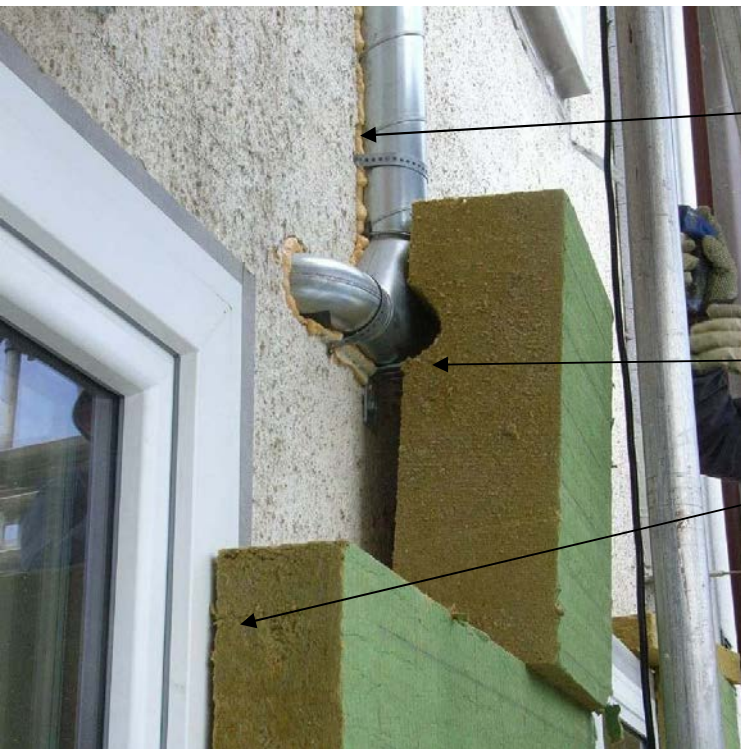
Abbildung 6-3: Dämmung der Lüftungsleitungen (1)
