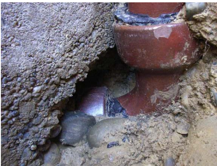
Abbildung 3-18: "Vergessener" Mauerdurchbruch für die Dachwassereinleitung
