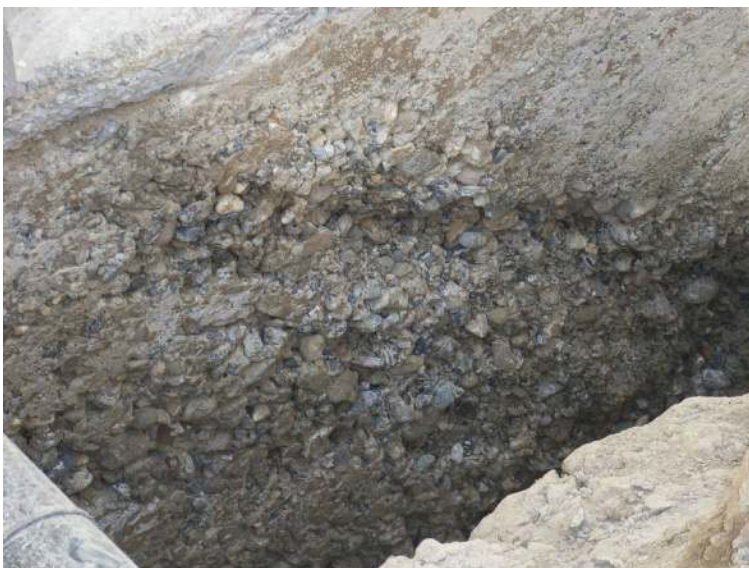
Abbildung 3-15: Schadhafte Beton-UG-Außenwand unter Terrain.
